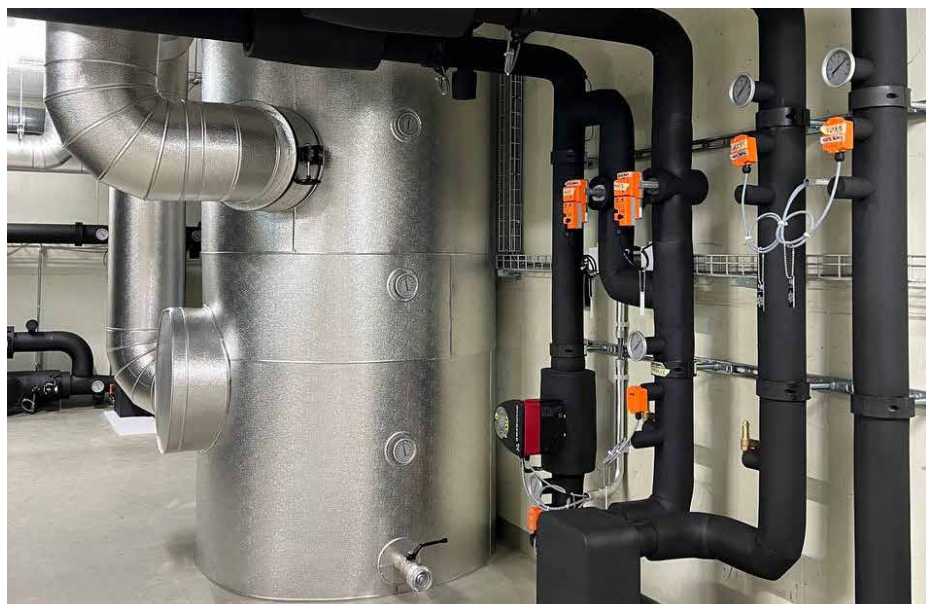
Wärmezentrale im Schulhaus Bündtli
